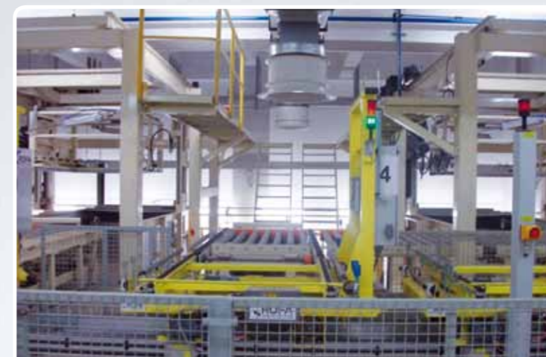
Übergabestation: Ein- / Auslagerung vom HRL bzw. Übergabe Feeder Transfer station: storage / removal from high-bay warehouse or transfer to feeder
