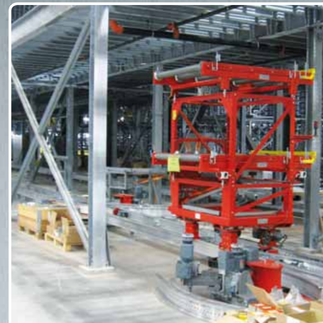
EPB-Anlage zur Kommissionierung PPC for commissioning
