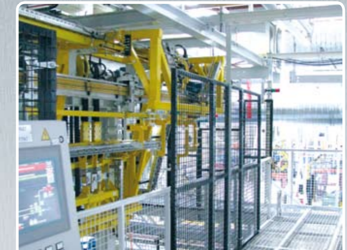
Hubstation mit Absicherung Elevator with safety fencing
