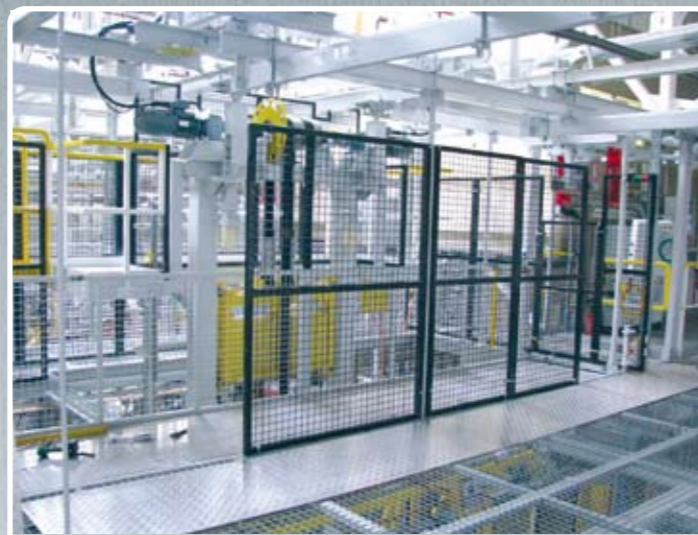
Verfahrbare Wartungsbühne vor einem Heber Moveable maintenance platform in front of an elevator
