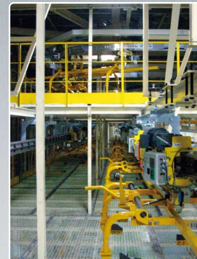
Fördertechnik auf mehreren Ebenen Conveyor technique on several floors
