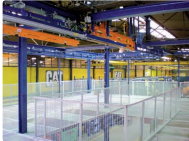
Aufnahmeheber: Rohbau Richtung Lackierlinie Charge station: paint shop direction paint line
